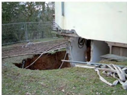
Abb. 1: Gebäudeschäden nach einem Erdbeben (o.) und Tagesbruch (u.)
