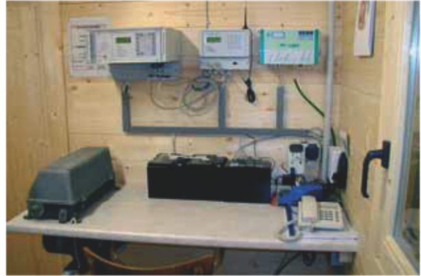
Abb. 10: Redundante Messtechnik zur Wasserstandserfassung, -registrierung und -übertragung (2002).
