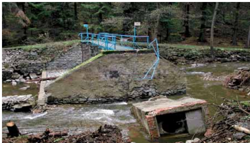
Abb. 1: Zerstörter Pegel Ammeldorf/Wilde Weißeritz im Osterzgebirge nach Ablauf der Hochwasserwelle im August 2002 (Quelle: Sächsisches Landesamt für Umwelt).
