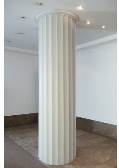
Aufwändig verkleidete Stahlstützen, um den repräsentativen Charakter des Eingangsbereiches zu unterstreichen.
